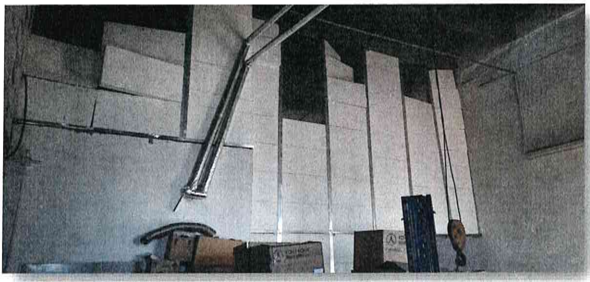
Zdjęcie 3. Ściana budynku produkcyjno-magazynowego
