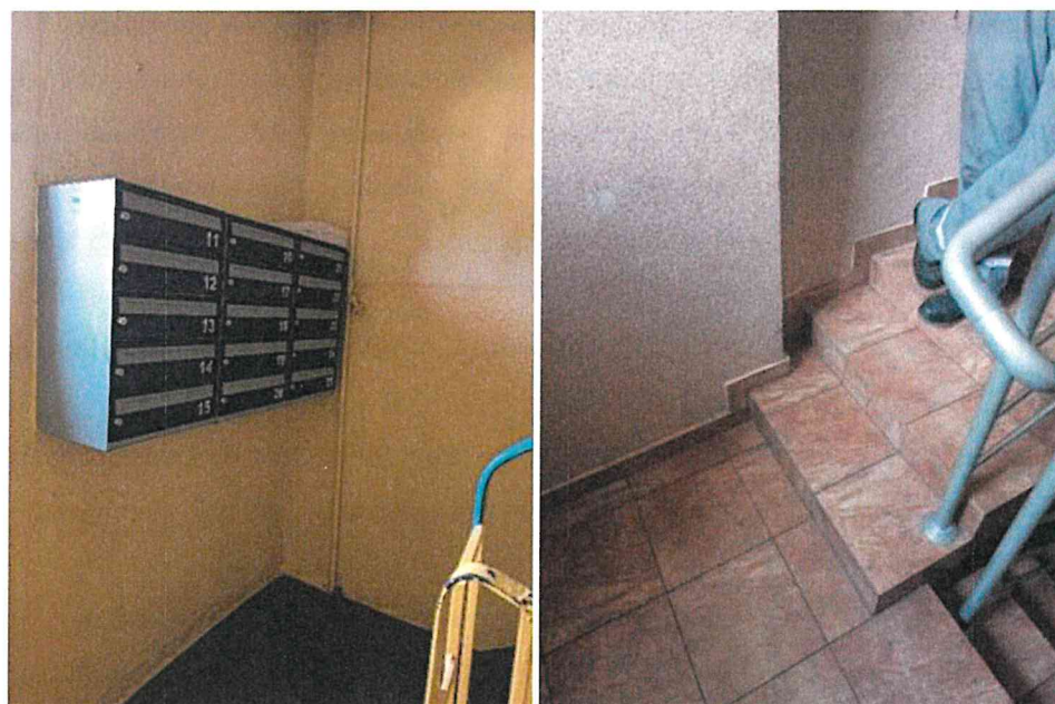
Zdjęcie 13. Zawężenie szerokości dróg ewakuacyjnych
