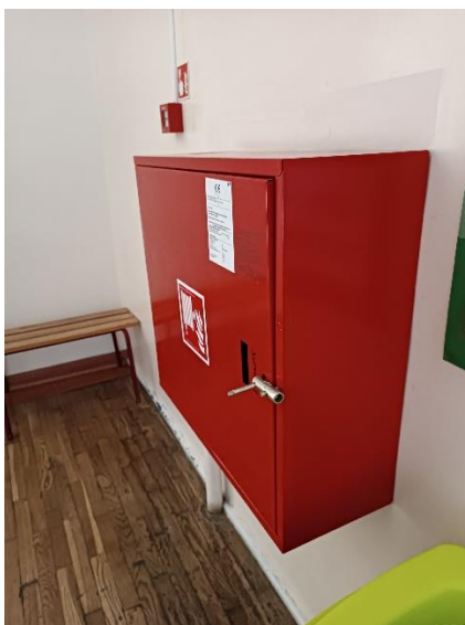
Rysunek 3. Skrzynka hydrantowa zamknięta na kłódkę.
