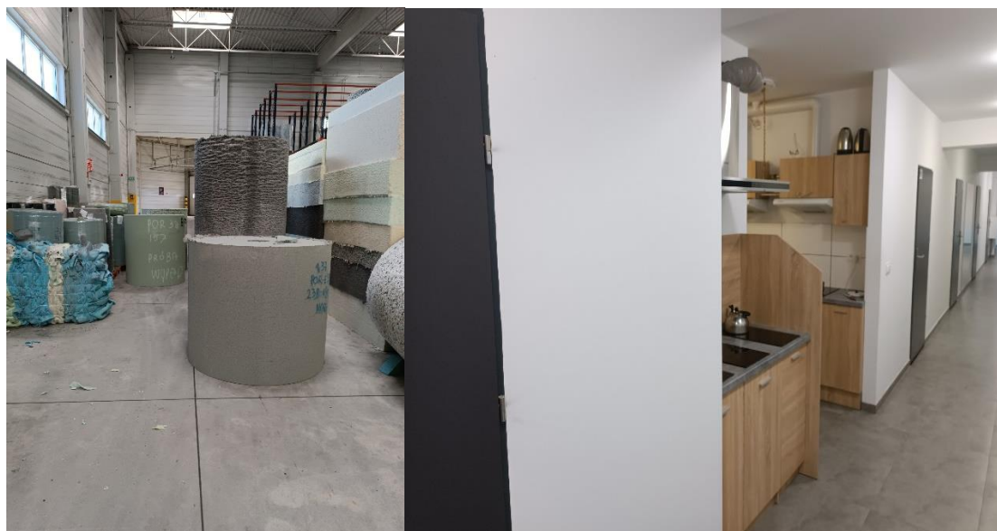
Rysunek 1. Pianka poliuretanowa składowana na drogach ewakuacyjnych – po lewo, aneks kuchenny wykonany na drodze ewakuacyjnej – po prawo.
